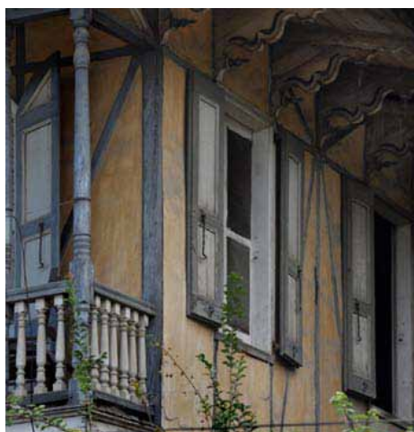
• 44 : Maison au 15 de la rue M montrant le revêtement intact du deuxième étage enduit de lait de chaux avec pigment, donnant une patine attrayante à la surface en stuc.
