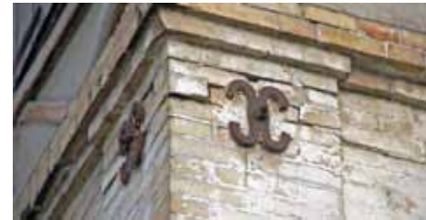
• 26 : Vue des plaques de fond décoratives dans un angle de cette construction en briques dénotant la présence d'entretoises horizontales dans les encoignures le long de chaque mur.
