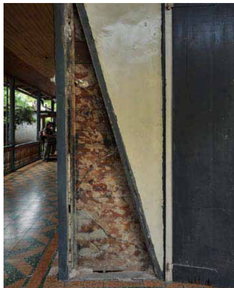
• 41 : Maison au 15 rue M montrant un hourdage de moellons. A gauche, une paroi s'est effondrée dans le tremblement de terre, révélant qu'elle avait été renforcée avec du fil de fer barbelé intégré en zigzag dans les entrevous.
