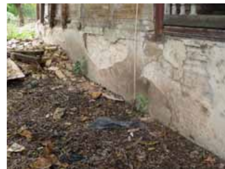
• 50 : Effritement de la finition extérieure en plâtre de cette maison sise au 84 avenue Lamartinière qui révèle deux segments contigus de la souche d'un mur de fondation. Un en pierres calcaires irrégulières, à g. et un en briques, à d.
