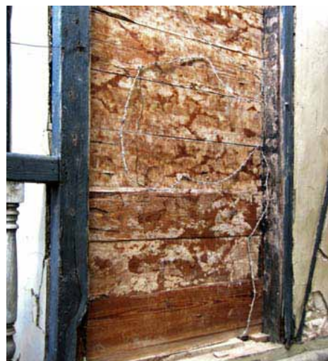
• 40 : Dans cette maison à colombage, le hourdage en moellons s'est effondré pendant le tremblement de terre, révélant le renforcement en fil de fer barbelé. Il s'agit là d'un exemple de matériaux mal adaptés à la construction utilisés à cause de leur disponibilité apparente. Le fil de fer barbelé était galvanisé et est encore en bon état.
