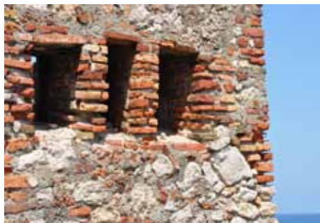
• Erosion par voie éolienne des briques de meurtrières
